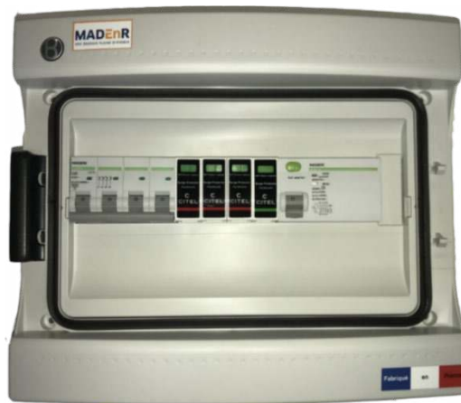
Figure 38 : Photo coffret AC TRI 1 onduleur 10kW ref 23301010
